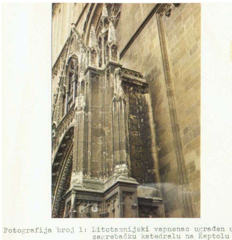
Slika 2.27. - Autohtoni kamen Zagreba litotamnijski vapnenac na Zagrebačkoj katedrali je u toliko trošnom stanju da ga je potrebno potpuno mijenjati. Glavni uzročnik oštećenja su procesi izazvani u kamenu karbonatnog sastava pod djelovanjem sulfatnokisele kiše.
